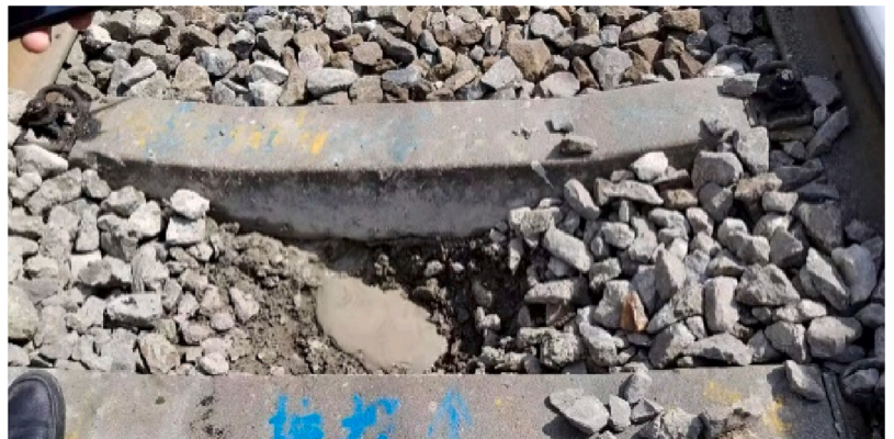
Fig. 18. Ballast layer fouling.
