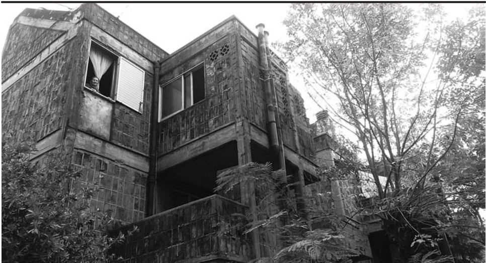
FIGURA 5. Barrio Justo Suárez: acercamiento a dormitorio y terrazas; se aprecian también paneles de ladrillo autoconstruidos
