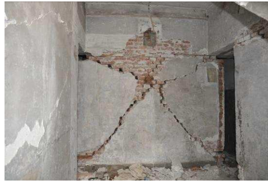
(d) Wall piece broken and extroversion
